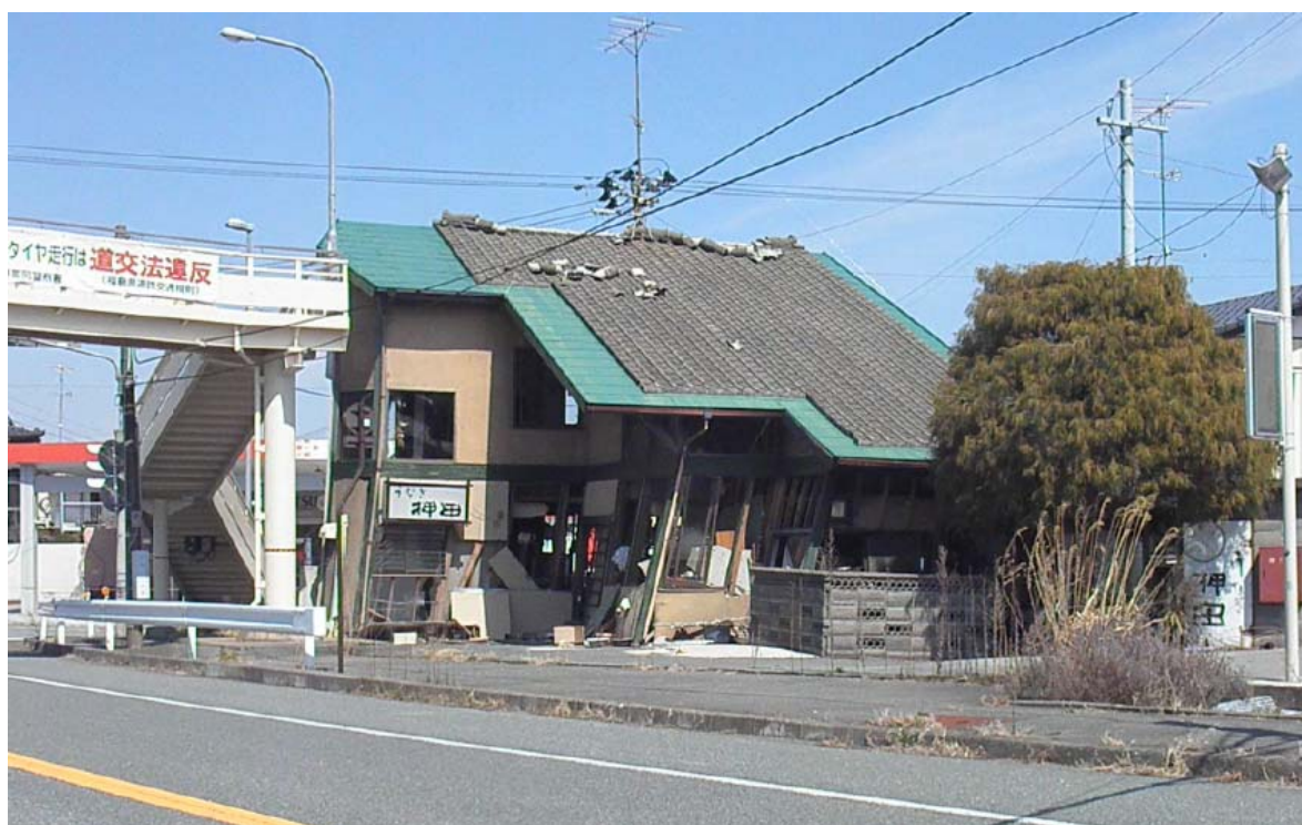
地震で損壊した6号線沿いのうなぎ屋
